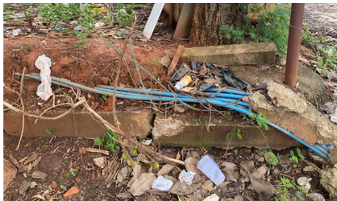
Figura 3: Infraestrutura precária das ligações coletivas propensa a vazamentos e contaminação.
